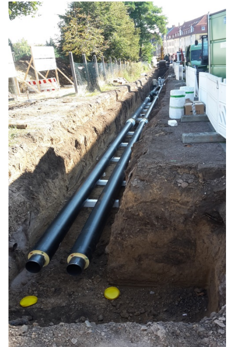
FW-Leitung im Erfurter Borntalweg; Quelle: SWE
